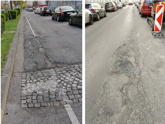
Abbildung 50: Fahrbahnschäden am Radfahrstreifen
