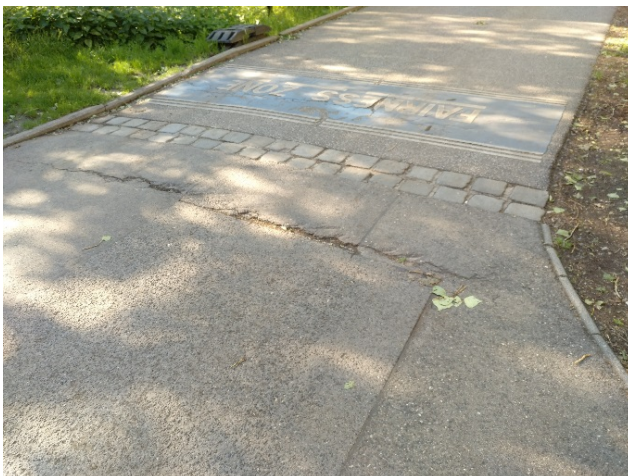
Abbildung 51: Fahrbahnschäden auf wichtiger Radroute
