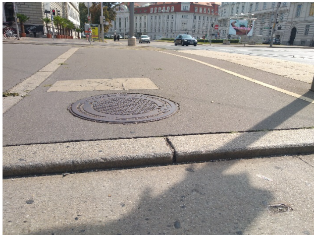
Abbildung 32: Zu hohe Gehsteigabsenkung
